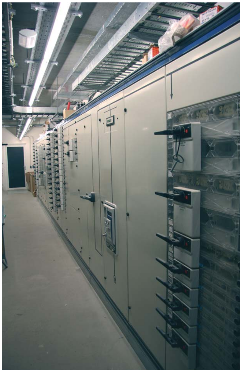
In de energiekelder staat de hoofdverdeler. Hier komt tot 3,8 MW elektrisch vermogen naar binnen met een spanning van 10 kV, die door drie trafo's van 1000 kV wordt getransformeerd naar laagspanning. Boven in de kantoortoren staat nog een vierde trafo, voor de voeding van dat hoge gedeelte van het gebouwencomplex.
